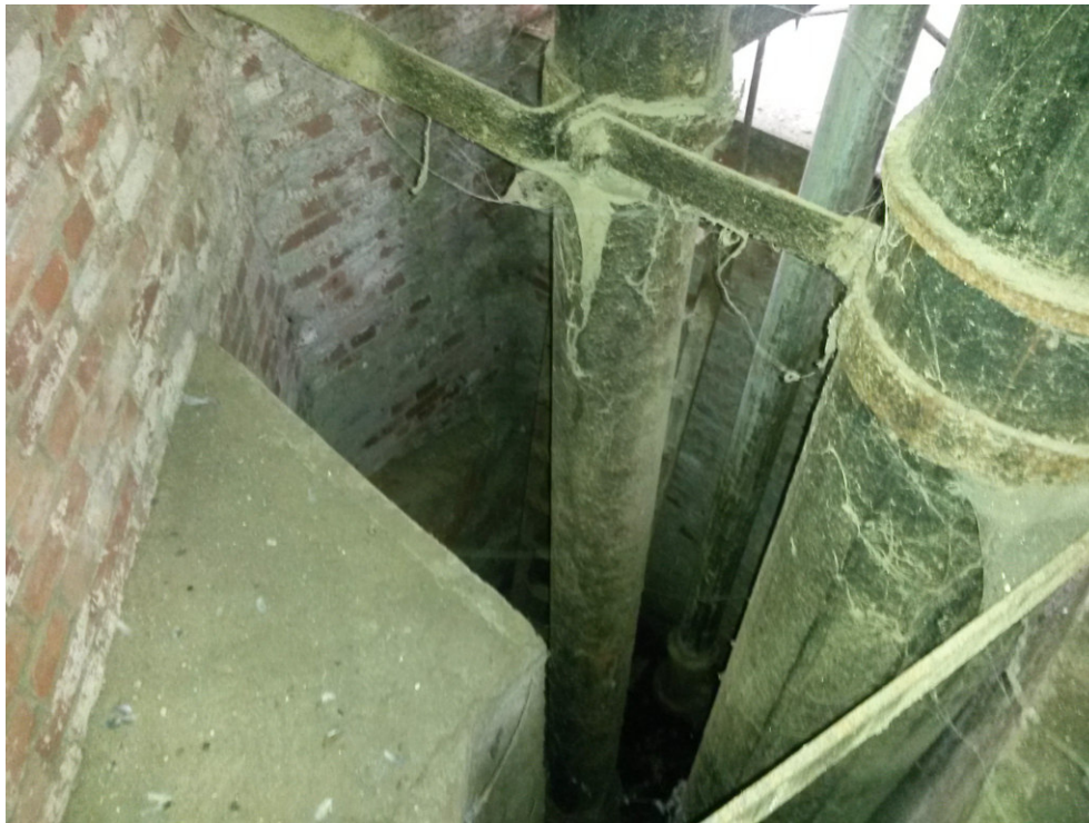
Bild 1 – Rohrleitungsanschlüsse im Erdgeschoß
