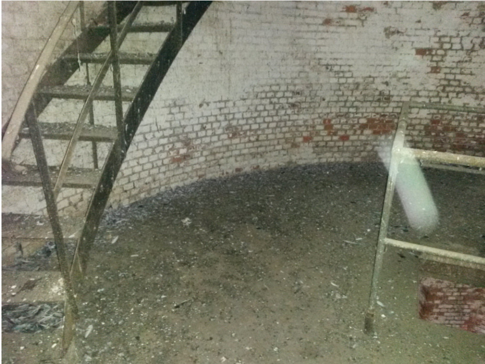
Bild 2 – Taubenkot im 1. OG
